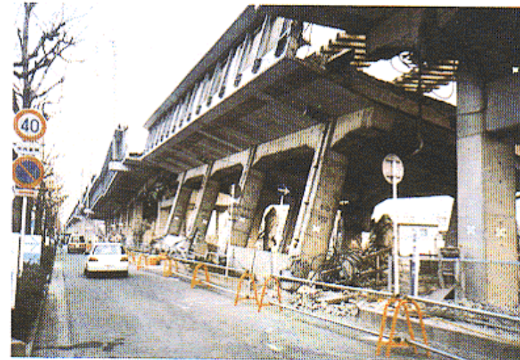
1-1-4 図 鉄道施設被災写真 (山陽新幹線: 西宮市)
